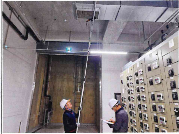
장 비 명 : ROTATING VANE 측정 내용 : 풍속 및 풍량 측정
