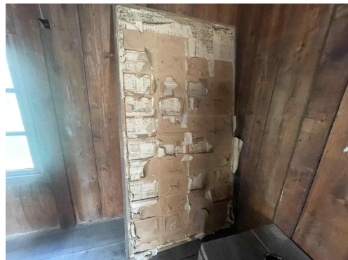
그림 8. 파손 미닫이문 현황 전체
