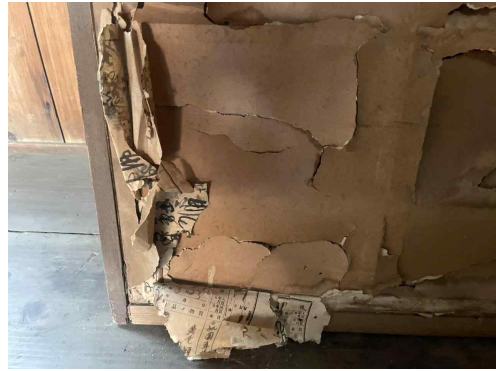
그림 10. 파손 미닫이문 현황 세부 2
